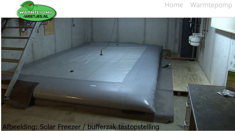
Afbeelding: Solar Freezer / bufferzak testopstelling
